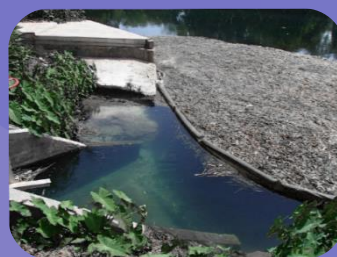
Barreira de Contenção em efluente
