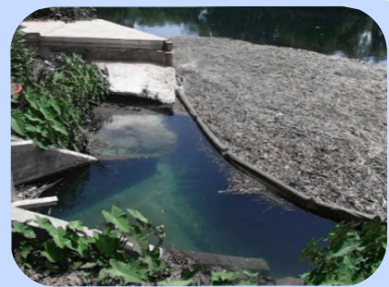
Barreira de Contenção em efluente
