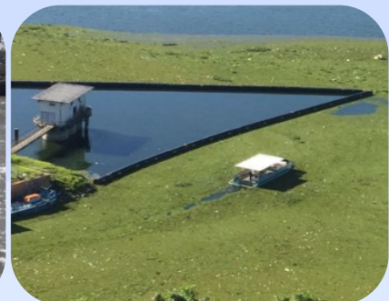
Barreira de Contenção em Estação de Captação de Água
